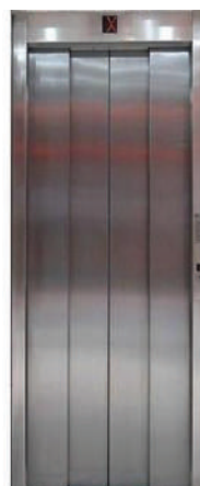
porte automatique centrale
